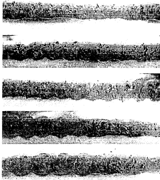
Рисунок 10 – Остаточные поверхностные волнообразные повреждения на дорожке качения ролика
